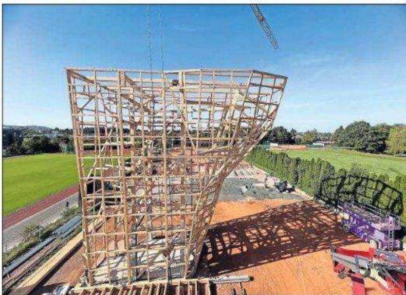
17 Meter hoch türmt sich das Grundgerüst auf, wirft seinen Schatten auf das Gelände der TSG und ist auch vom Rasenplatz der Uni aus (links) deutlich zu sehen. Unten wird ein Teil des Dachs zusammengebaut. FOTO: HUZL
